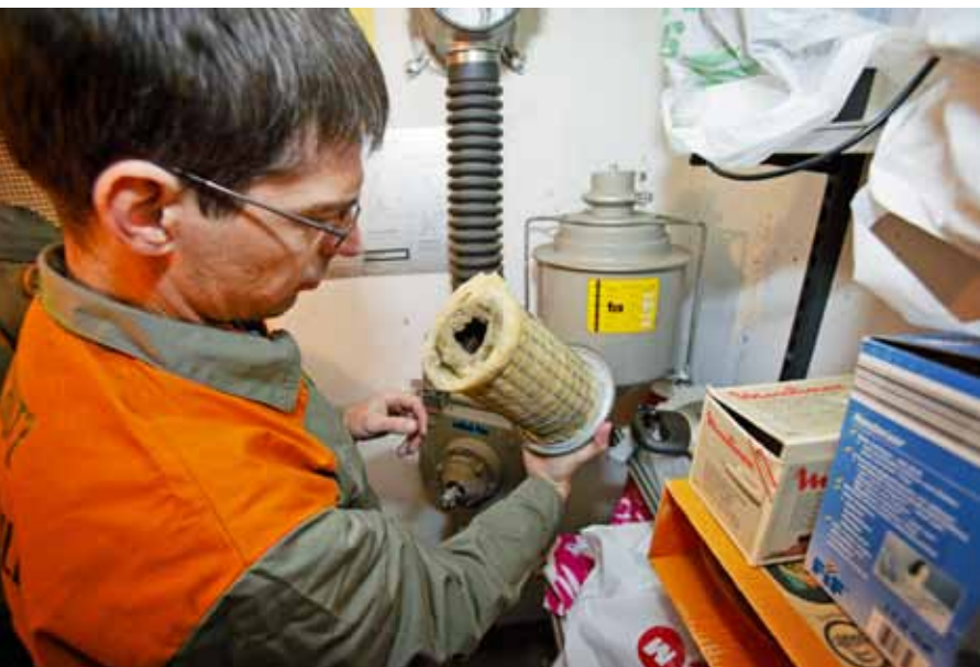
Matthias Lüscher contrôle un filtre à air et met ensuite l'appareil de ventilation en marche.
