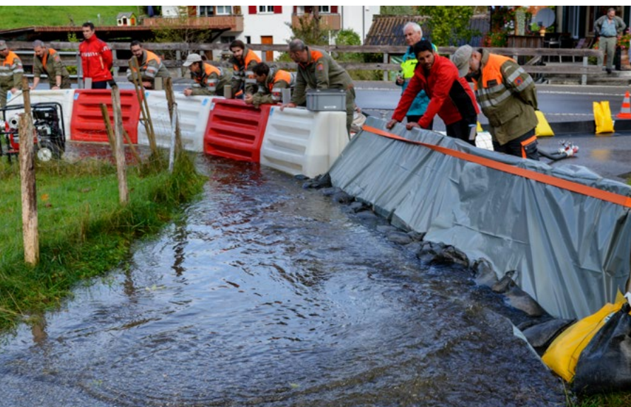
Le dispositif mobile de protection contre les crues prévient l'inondation: à droite, la construction classique en palettes et film plastique avec sacs de sable. A gauche, la digue en matière synthétique rouge et blanche remplie d'eau.
