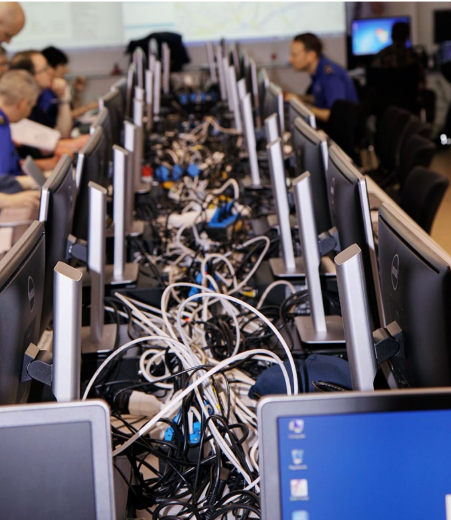
Se trouvant dans le même immeuble, la centrale d'engagement et le bureau de la cellule cantonale de crise peuvent communiquer directement pour se préparer en cas d'événement.
