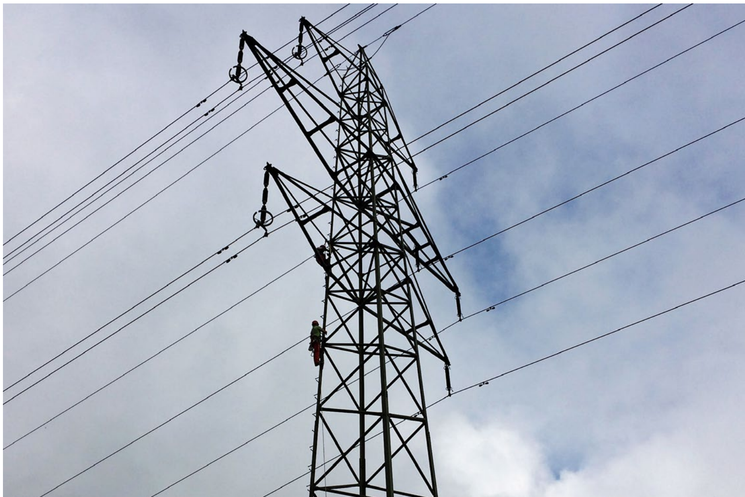
Des monteurs de lignes aériennes occupés au remplacement d'isolateurs, un travail qui requiert une aptitude à travailler en hauteur et une expérience de la grimpe.
