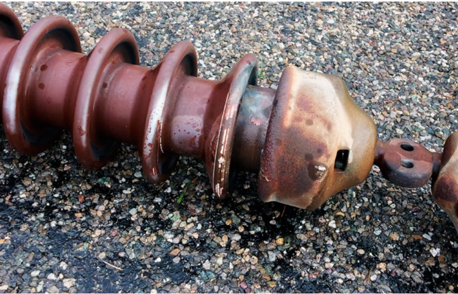
L'isolateur endommagé par la foudre.
