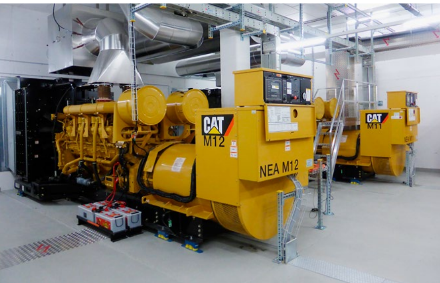
De nos jours, de nombreux bâtiments disposent d'une installation électrogène de secours. Celle-ci peut toutefois s'avérer inutile lorsqu'une panne de courant à grande échelle s'accompagne d'une défaillance du réseau de télécommunications.
