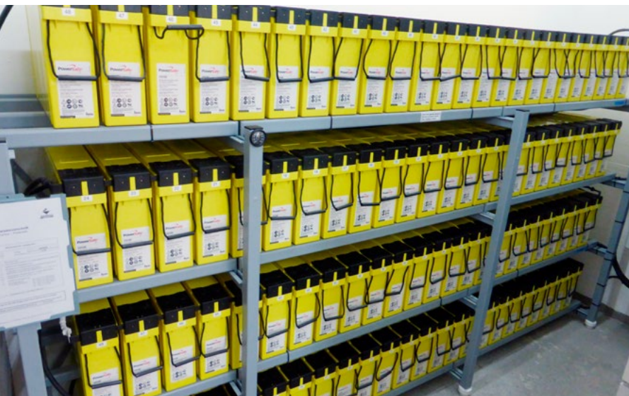
Des batteries garantissent une alimentation électrique sans interruption (ASI).
