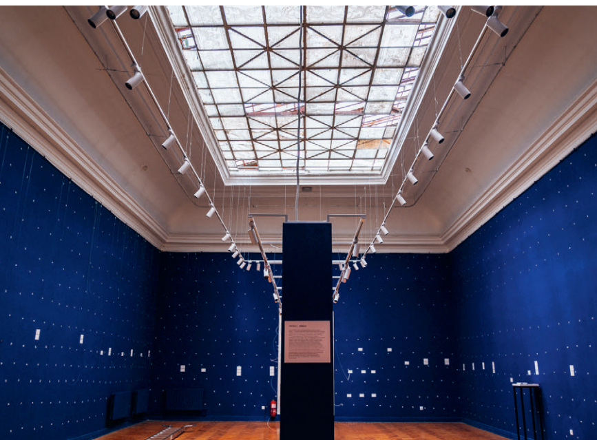
4 Verrière du musée des beaux-arts d'Odesa avant et après réparation. © UNESCO (Photo : Ivan Strahov)
