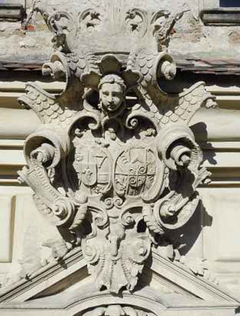
1 Hauptwappen von Schloss Greilhenstein (Niederösterreich) aus Zogelsdorfer Kalkarenit, Niederösterreich. Vorhandene Schäden sind hauptsächlich auf Frost-Tau-Wechsel zurückzuführen. Foto © Institut für Konservierung und Restaurierung, Universität für angewandte Kunst Wien.
